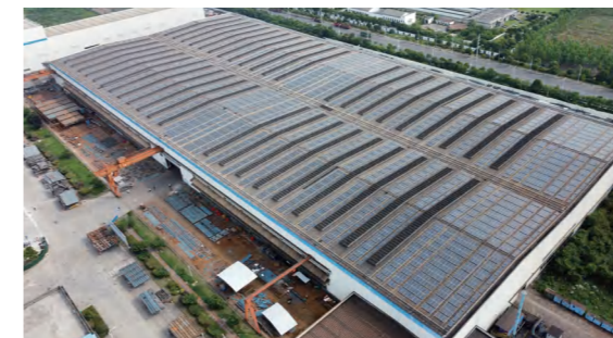
车间屋面分布式光伏发电板
