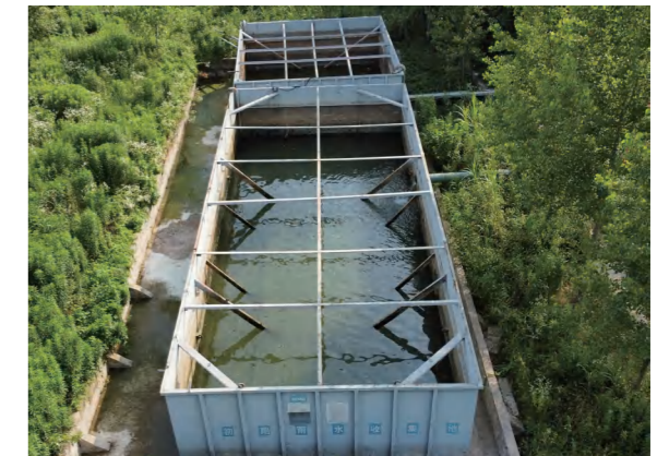
码头雨水收集池
