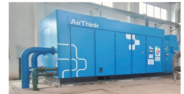
空压机节能改造
